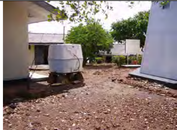
写真 2-4: 雨水集水タンク (雨水を集水し、生活用水に当てている。電力は自家発電機による。)
