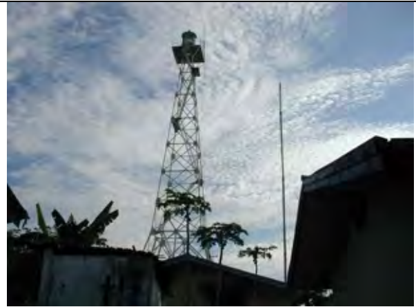
写真 4-2: タンジュン・ブラキット灯台（鉄塔頂部）に灯器が設置されているが、鉄塔が老朽化しており、鋼材の腐食も激しい。
