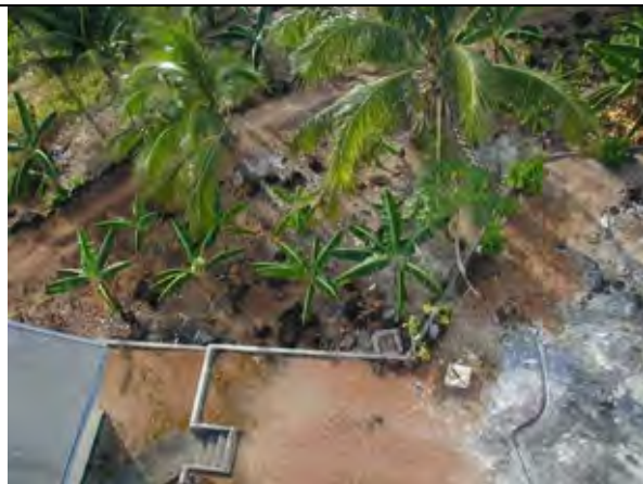
写真 4-3: レーダー／通信用鉄塔建設予定地（既存の道路（未舗装）は先方政府負担により移設。）
