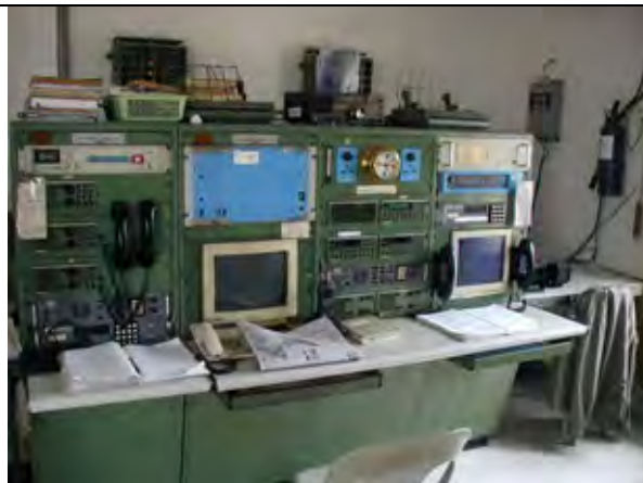
写真 3-5： 沿岸無線局内通信機器類
