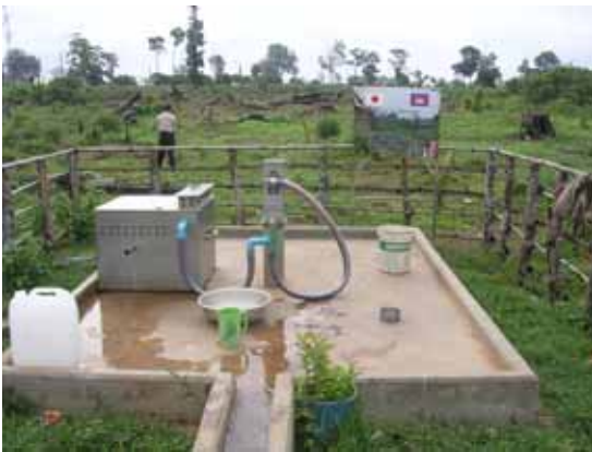
写真-9：鉄分除去装置 無償資金協力「コンポンチャム州村落飲料水供給計画」（2006～2007 年度）で設置された鉄除去装置（ステンレス製）。
