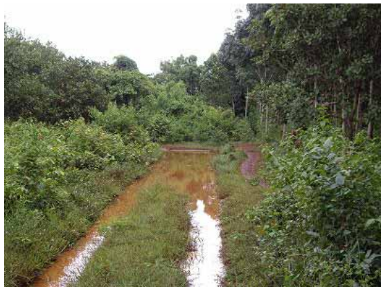
写真-10：アクセス状況 対象村落 Prei 村（No.19 村）に向かう道路。雨期になると道路が冠水し、重車輛の通行は困難となる。
