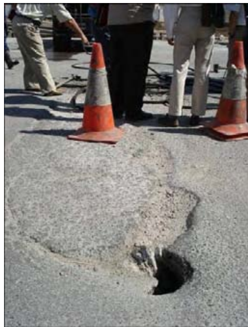
写真 1-8-3 マンホール付近の陥没した道路
