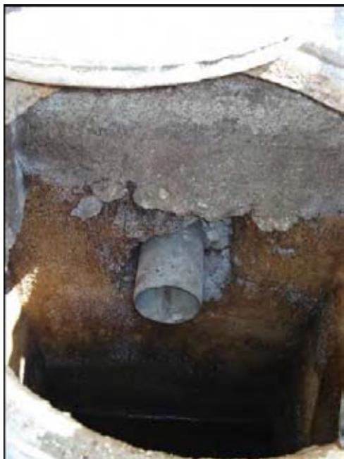
写真 1-8-2 隙間から砂利の流入が疑われる 管のひとつ
