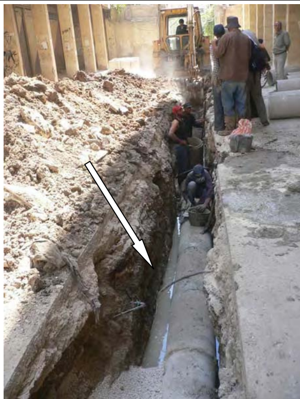
写真-2-9-2 ダマスカでの管渠敷設替え現場 (排水不良、砂基礎なし、管渠も曲がっている)
