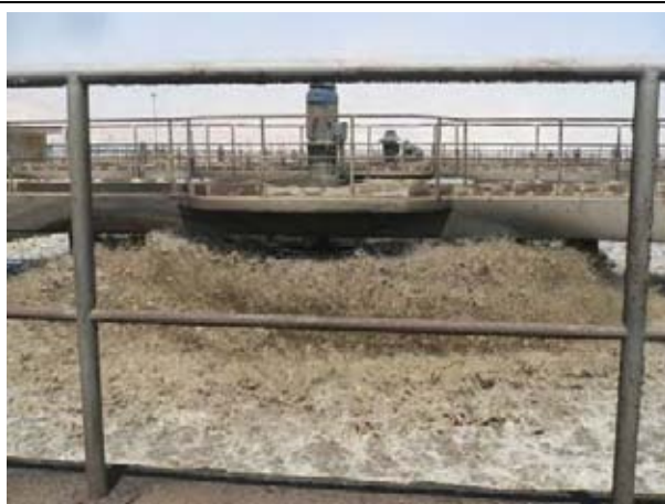
写真 B-10 アドラ下水処理場 （反応槽：表面曝気装置）
