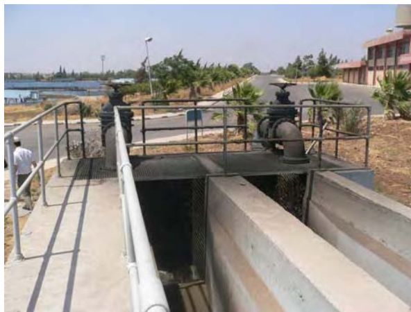
写真 D-4 ホムス下水処理場 （流入水路）
