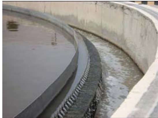
写真 1-8-9 最終沈殿池(茶色く濁っている)と越流水
