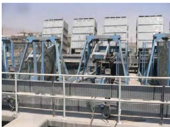
写真 B-7 アドラ下水処理場 （スクリーン）
