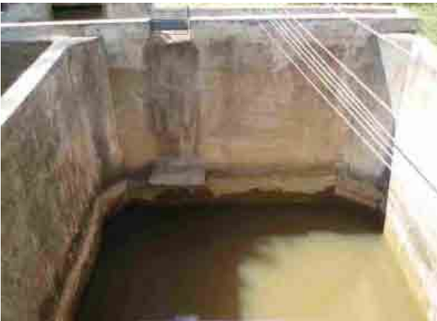
Planta de tratamiento de agua de la comunidad de Peru, Departamento de Beni Filtro lento
