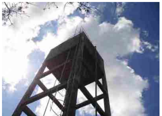
Planta de tratamiento de agua de la comunidad de Peru, Departamento de Beni Tanque elevado hecho de hormigon armado
