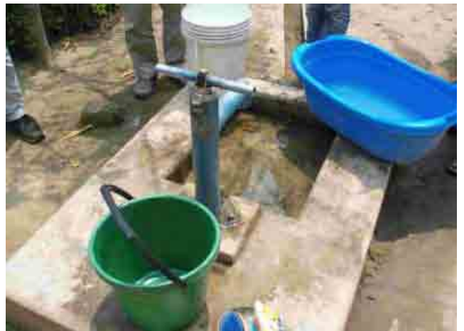
Departamento de Beni 057 La Asunta Pozo equipado de una bomba manual
