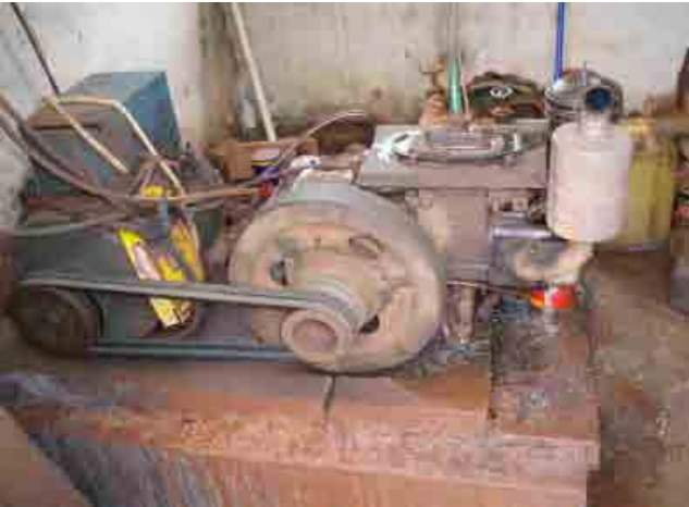
Departamento de Beni 201 12 de octubre Bomba instalada en la boca de un pozo
