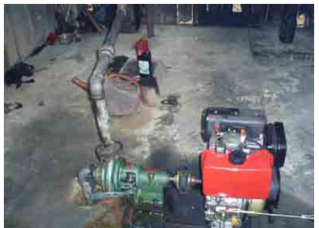
Departamento de Pando 050 Filadelfia Bomba impulsora instalada dentro de la caseta de captacion de agua de arroyo
