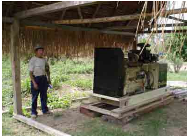
Departamento de Beni 151 Villa San Pedro Generador para impulsar el agua
