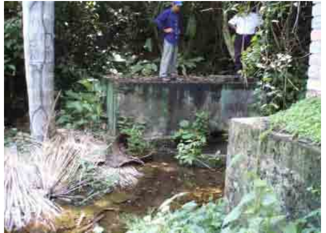
Departamento de Beni 210 Tumichucua Captacion en un arroyo
