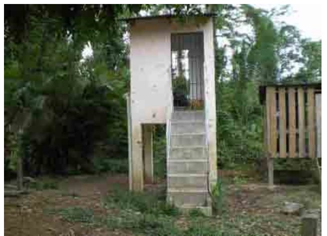
Departamento de Pando 044 Cachelita Boja Caseta de control de bomba para la captacion de agua
