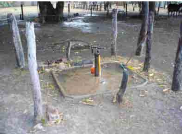
Departamento de Beni 115 Puerto Yata Pozo equipado de bomba manual
