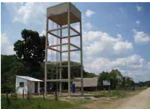
Beni, Proyecto piloto Puerto Santa Rosa Fuente de agua. Tanque elevado y caseta de operacion.
