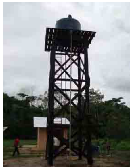
Pando, Proyecto piloto Puerto Copacabana Tanque elevado y caseta de operacion.
