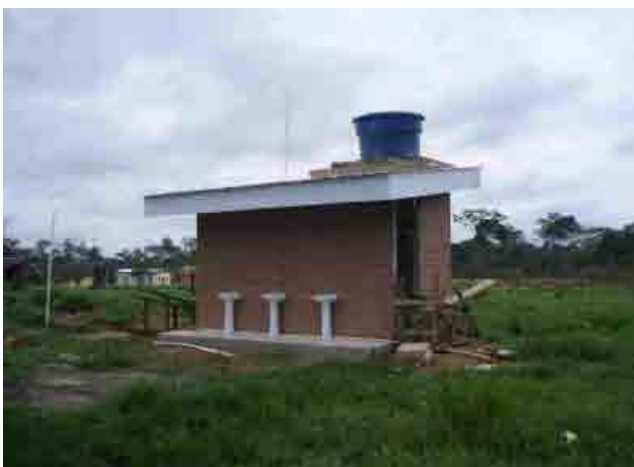
Departamento de Pando 018 Nareuda Instalaciones sanitarias (letrinas)
