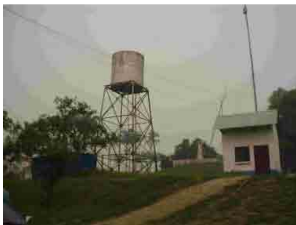
Departamento de Beni 007 Loma Suarez Tanque elevado de acero
