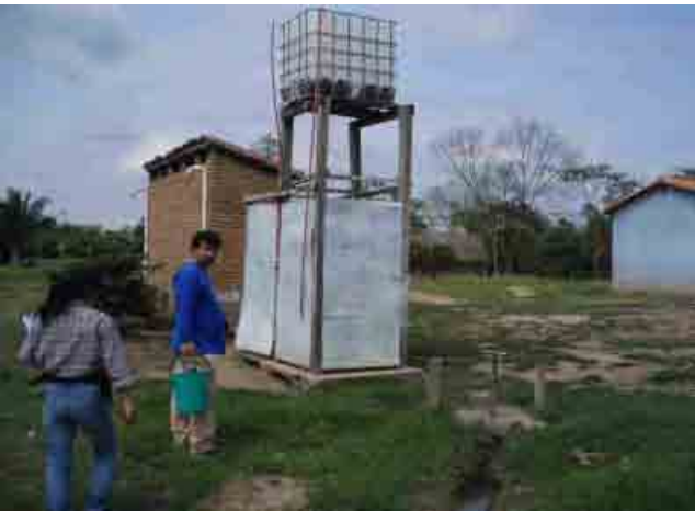
Departamento de Beni 151 Villa San Pedro Deposito elevado e instalaciones sanitarias (letrina y ducha)
