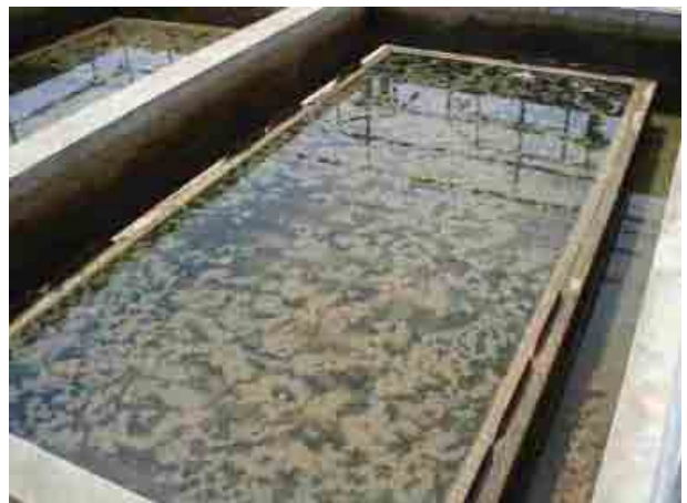
Planta de tratamiento de agua del Municipio de Santa Ana, Departamento de Beni
