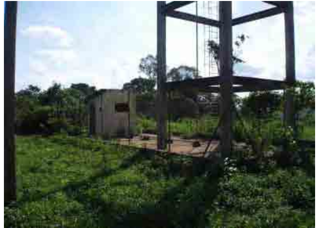
Departamento de Beni 204 Esperanza Caseta de control de pozo debajo de un deposito elevado
