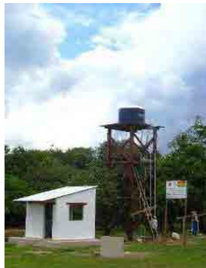
Beni, Proyecto piloto Puerto San Borja Fuente de agua. Tanque elevado simple y caseta de operacion.
