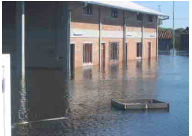
Planta de tratamiento de agua del Municipio de Trinidad, Departamento de Beni Parte inundada por el desborde el rio y el almacen de la planta de tratamiento de agua
