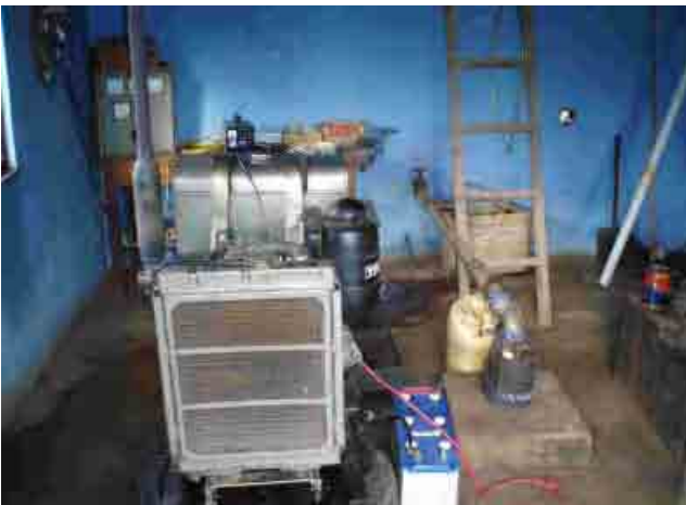
Departamento de Beni 123 San Joaquin Pozo y generador para bombeo
