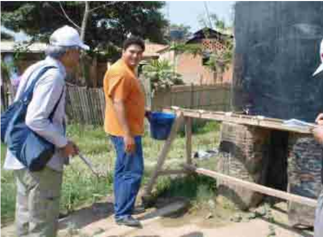
Departamento de Beni 008 Puerto Varador Llave publica aprovechando un tanque de polietileno
