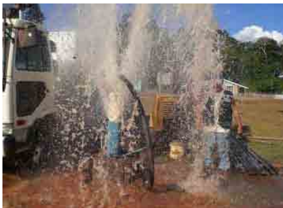
Estudio de perforacion de pozos Lavado de pozo por medio de equipo extraccion por aire.
