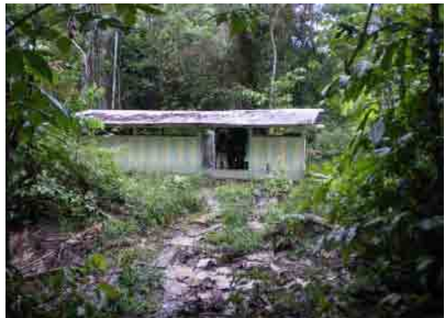
Departamento de Pando 075 Avarora Deposito del estanque
