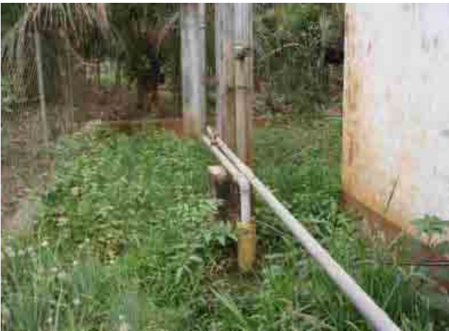
Departamento de Beni 065 Galilea Tuberia de un deposito elevado
