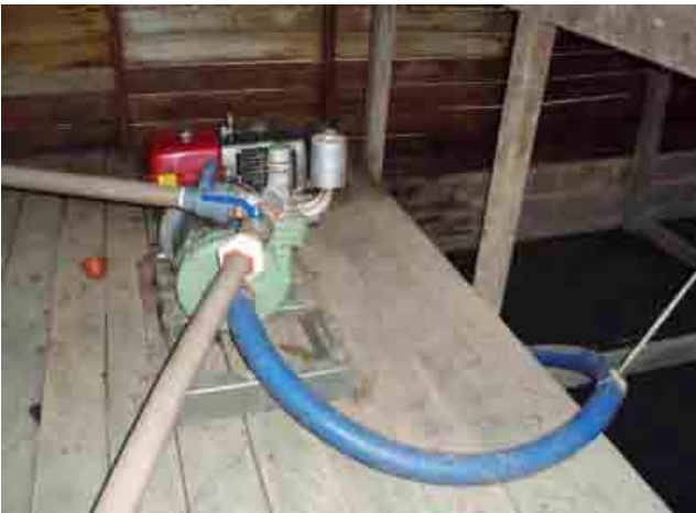
Departamento de Pando 066 Batraja Captacion de agua del deposito del estanque
