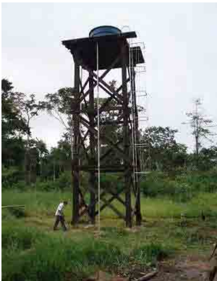
Pando, Proyecto piloto Puerto Nueva Vida Tanque elevado.
