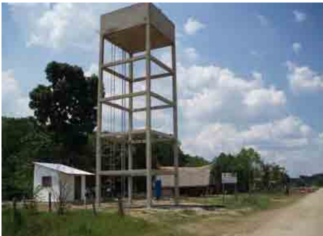
Proyecto piloto (Santa Rosa, Departamento de Beni) Pozo, tanque elevado, caseta de control y filtro purificador
