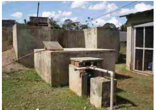
Planta de tratamiento de agua de la comunidad de Peru, Departamento de Beni Salida del filtro lento
