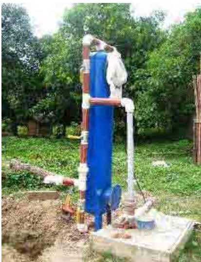
Beni, Proyecto piloto, Puerto San Borja Fuente de agua. Se instalo un dispositivo para eliminar el Manganeseo, en la salida del pozo.
