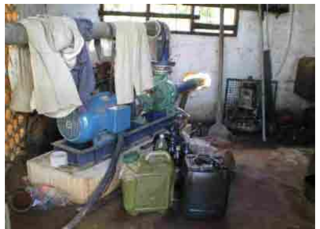
Departamento de Pando 035 Porvenir Bomba impulsora
