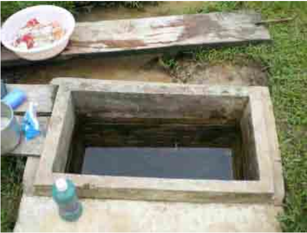
Departamento de Pando 025 Villa Rosario Barzola Deposito en la vertiente de fuente de agua
