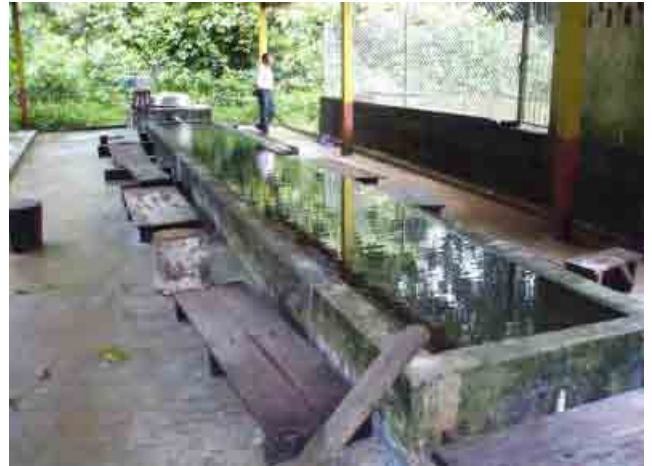
Departamento de Pando 118 Sena Instalaciones de captacion de agua en un arroyo
