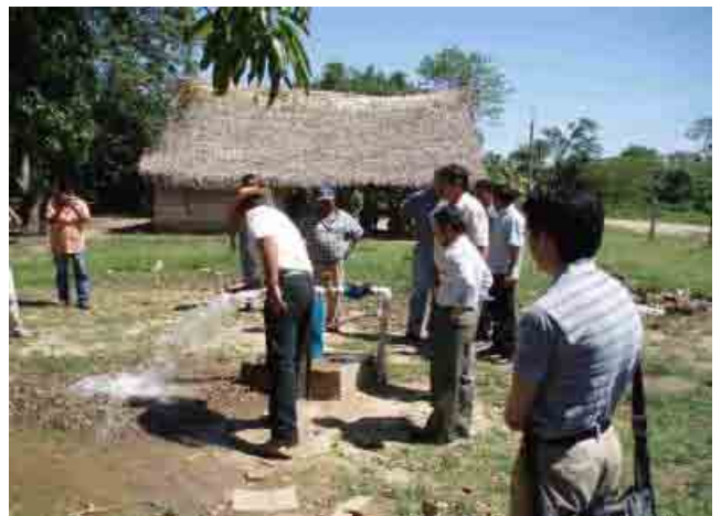
Instalaciones piloto Pozo
