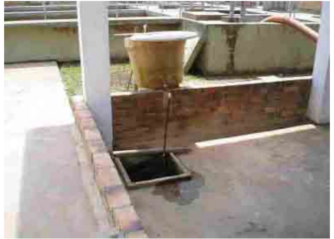
Planta de tratamiento de agua del Municipio de Santa Ana, Departamento de Beni Tanque de agua tratada
