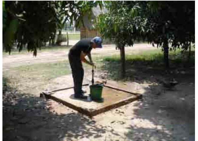
Departamento de Beni 165 Fatima Pozo equipado de bomba manual
