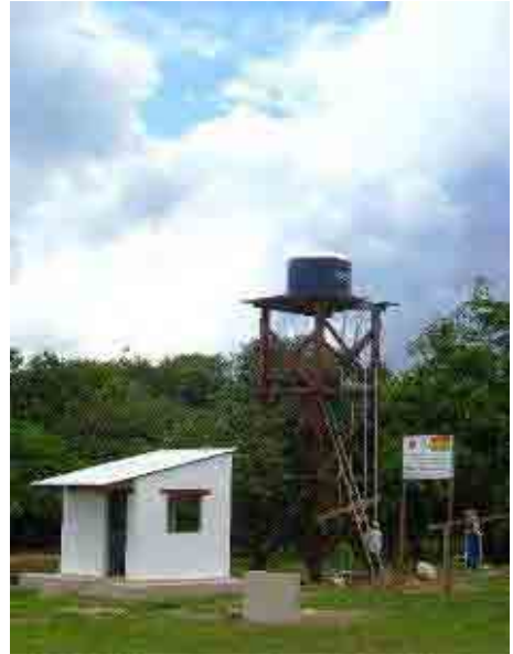
Proyecto piloto (Puerto San Borja, Departamento de Beni) Pozo, tanque elevado, caseta de control y filtro purificado
