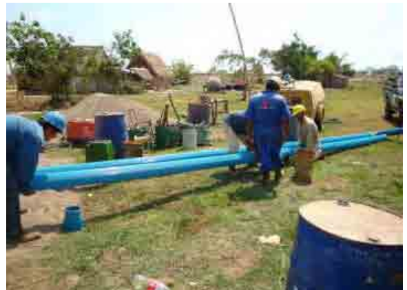
Estudio de perforacion de pozos Preparacion para insertar la tuberia de revestimiento.
