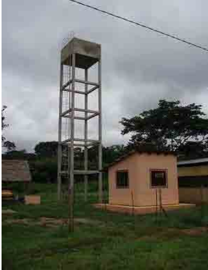
Pando, Proyecto piloto Puerto Luz de America Tanque elevado y caseta de operacion.
