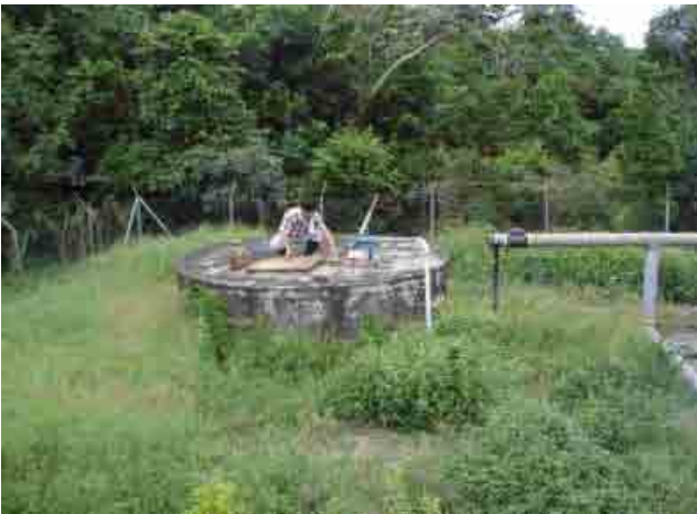
Departamento de Beni 126 San Ramon Tanque de tratamiento de agua
