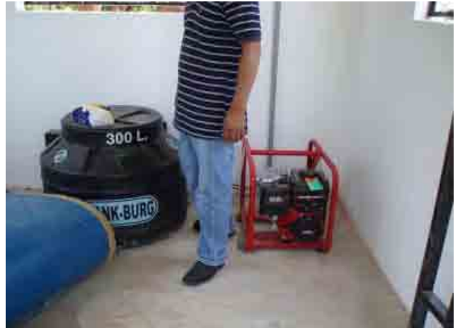
Proyecto piloto (Puerto San Borja, Departamento de Beni) Generador y tanque de cloro
