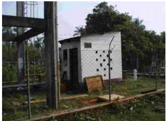
Departamento de Beni 068 La Embocada pozo y caseta de control
