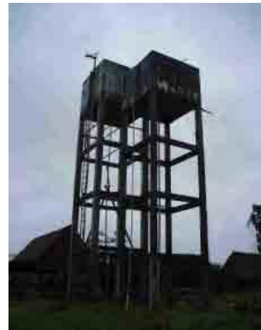
Departamento de Pando 118 Sena Tanque elevado hecho de hormigon armado
