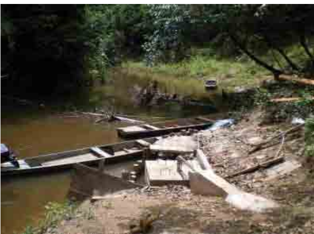
Departamento de Pando 044 Cachelita Boja Instalacion para la captacion del agua del rio
