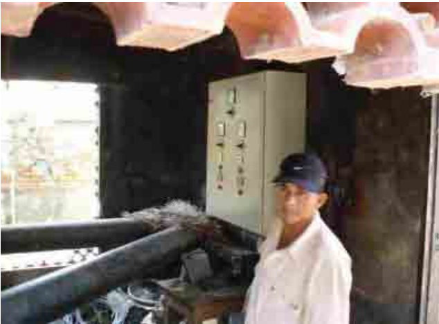
Planta de tratamiento de agua del Municipio de Santa Ana, Departamento de Beni Bomba impulsora de agua
