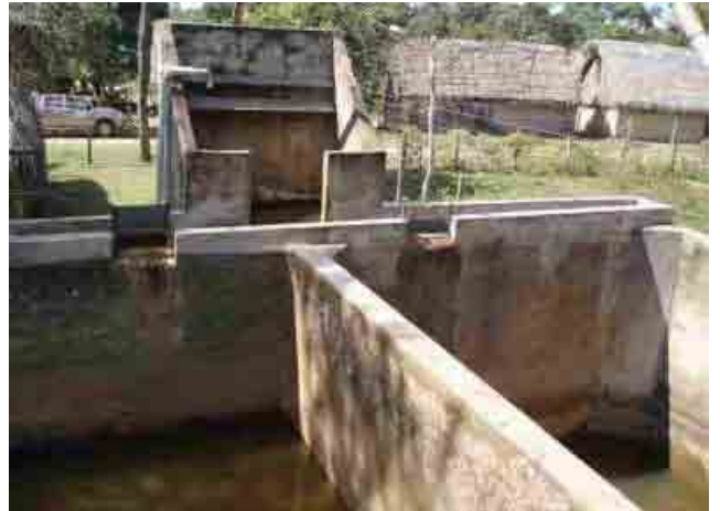
Planta de tratamiento de agua de la comunidad de Peru, Departamento de Beni Vertedero
