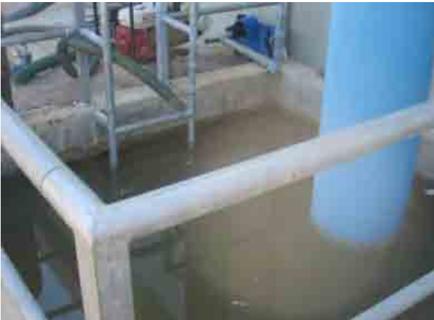
Planta de tratamiento de agua del Municipio de Trinidad, Departamento de Beni
