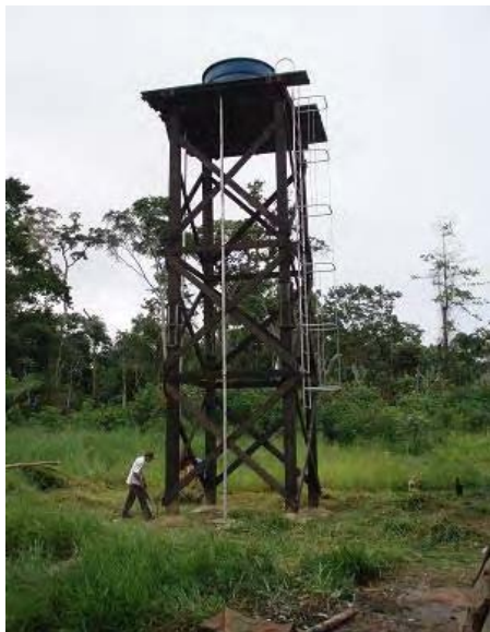
バンド県 パイロットプロジェクト Nueva Vida 高架水槽
