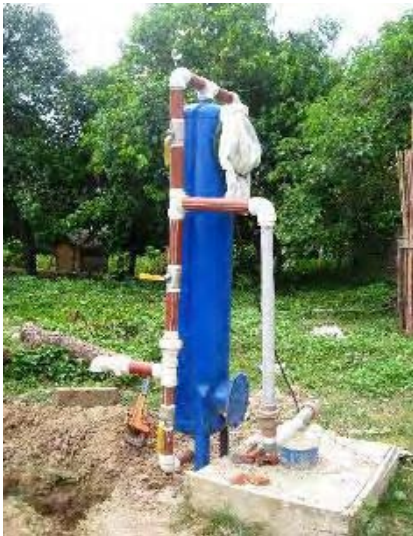
ベニ県 パイロットプロジェクト Puerto San Borja 水源 井戸からの流出部に除マンガン装置を装着している
