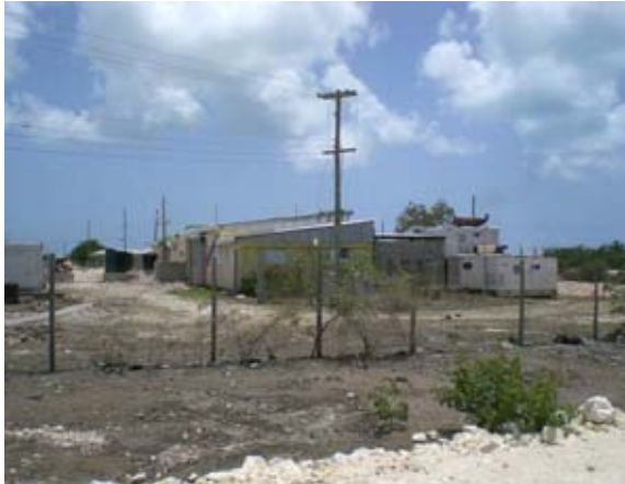
バーブーダ島 島内唯一の発電所 ディーゼル発電機3基、総発電能力1,110kW
