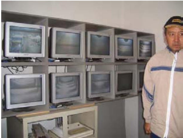
Bishkek-Osh (EM02) Too Ashua Pass トンネル管理事務所。アジア開発銀行によって設置されたトンネルモニタリング機器
