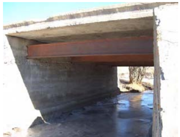
Kochkor-Arai-Tjuya-Ashuu (EM16) Jungal より西 130km。鋼製 I 型桁。しかしながら、床版が桁の上に載っていない。
