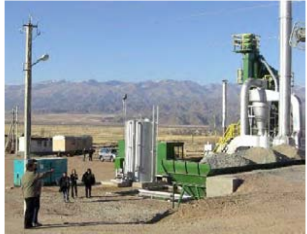
Bishkek-Torugart Road (EM07)。日本から供与されてアスファルトプラント（砕石クラッシャーを併設）
