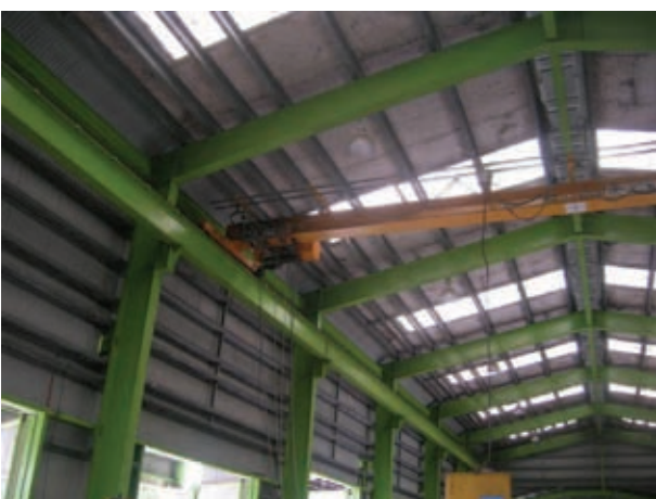
ワイヤー切断で故障中のクレーン
