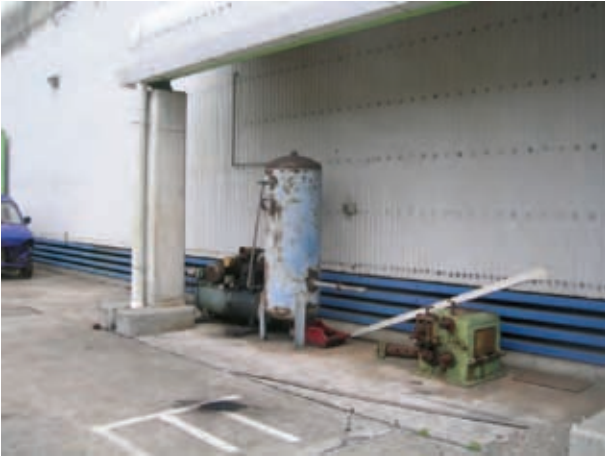
修理不能となっている中国製大型コンプレッサー
