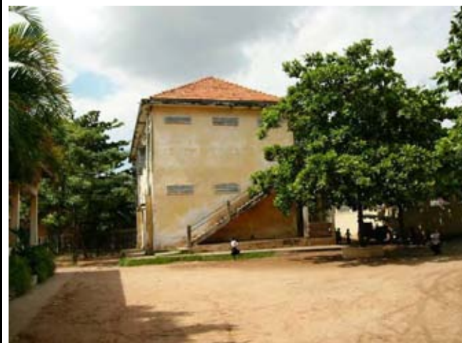
老朽化が激しく躯体に損傷がある1954年建設の校舎
