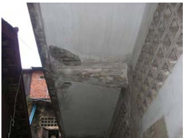
既存校舎軒天のコンクリート剥離
