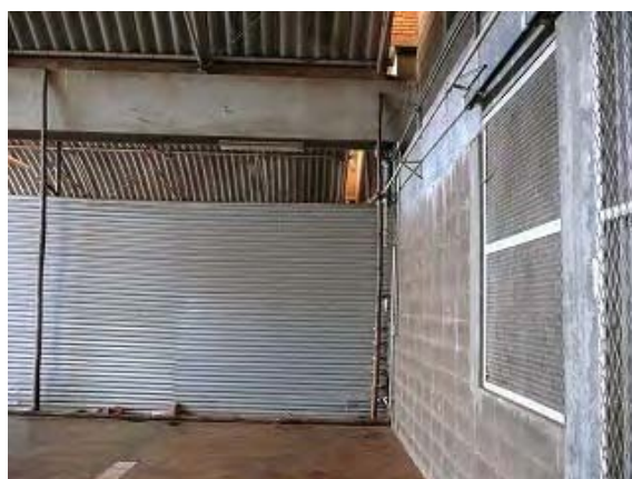
6 .整備工場内インフラは再活用可能。給水、配電などの施設設備は継続使用可能な状態
