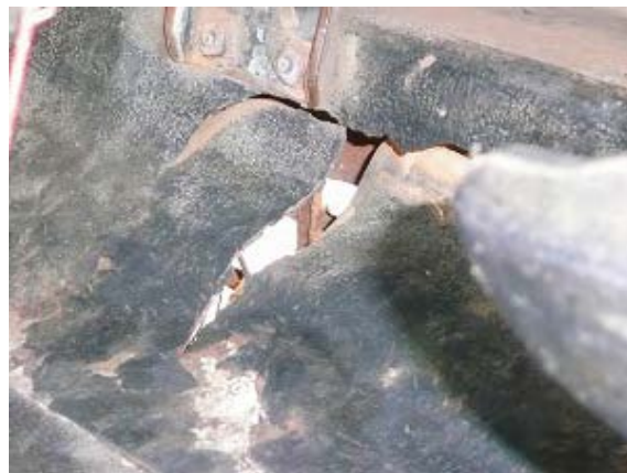
4．2005年調達車両の運転席床板にひび割れ。脆弱部分に補強策が必要と指摘あり。
