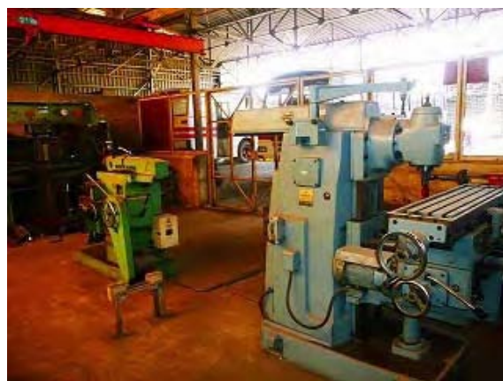
6 . 過去の無償資金協力による維持管理機材。老朽化のため継続使用が困難な状態
