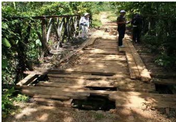
木床版は痛んでいる。
