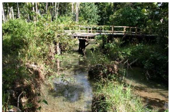
下流側から橋をみる。洗掘されたために、木が倒れている。
