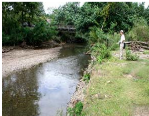
洗掘地点より現橋梁位置をみる。
