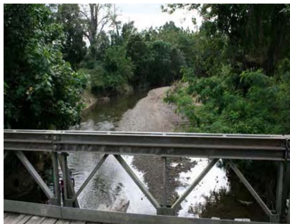
上流側をみる。右岸である左側の川岸が洗掘されている。
