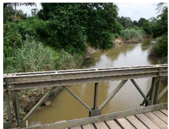
下流側、右へと折れている。洗掘もある
