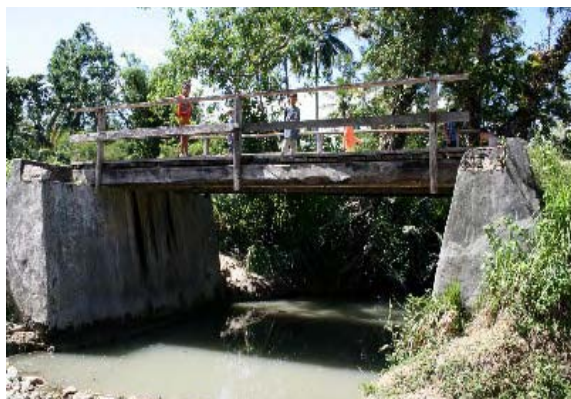
下流側からみた橋。下流側に洗掘があり、流れを変えると危険
