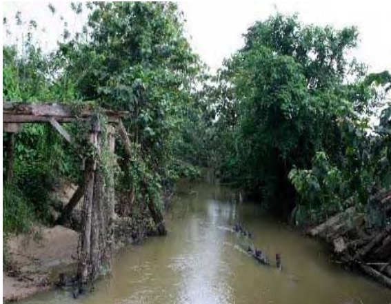
上流側の仮設の木橋からみる落橋した旧橋。右岸側から。スパンは約20m
