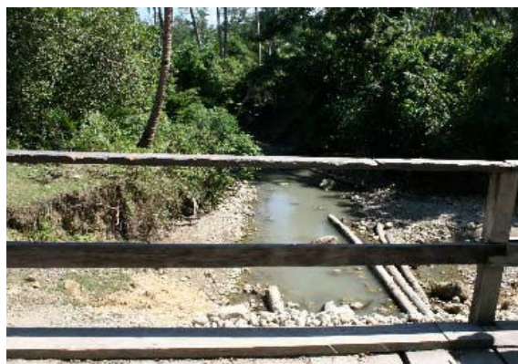
下流側、この先に洗掘の激しい箇所がある。
