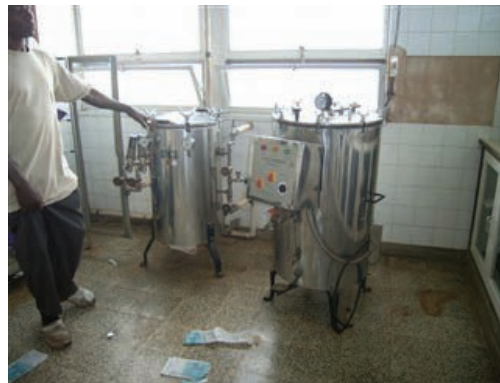
故障している滅菌器
