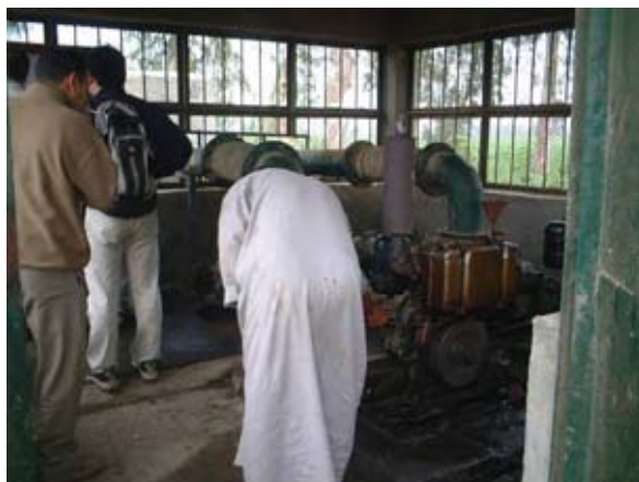
ポンプ場内部
