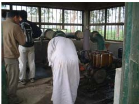
ポンプ場の内部
