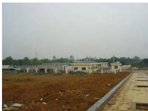
Hình 4.2.7 Hiện trạng xây dựng các nhà máy xử lý nước thải
