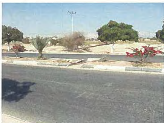
路面上が降雨により湛水する（30～50cm）排水を流すため削られた中央分離帯
