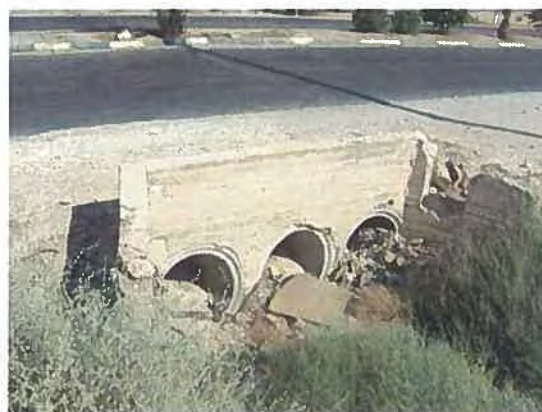
土砂等で閉塞された道路横断排水管
