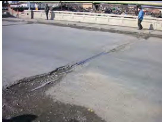
北側伸縮継ぎ手部をオーバーレイ舗装、鋼製チャンネルが一部を残して喪失
