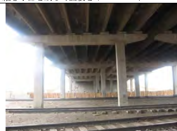
北側の橋脚には大きな損傷は見られないが、プレキャストブロックを積み重ねた構造であり、地震などの急激な水平力を生じた場合、損傷の可能性が高い。
