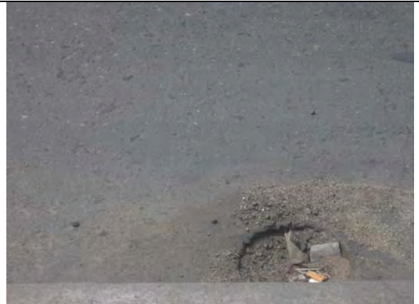
路面排水口の径が小さく詰まっている。
