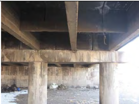
桁下沓座部の損傷およびプレキャスト床版接合部の遊離石灰
