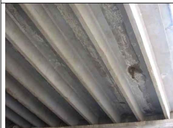
南側床版の間詰めコンクリートの遊離石灰 横桁がない。
