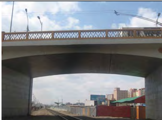
跨線部、床版桁が壁式橋脚と剛結している、桁がヒンジ結合となっており、重交通が繰り返された場合、構造上の弱点となる可能性がある。
