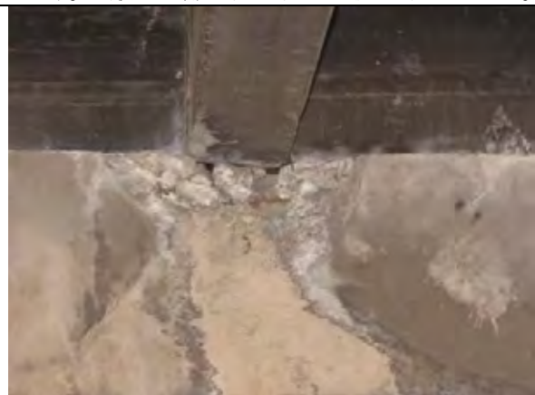
桁下沓座部の損傷
