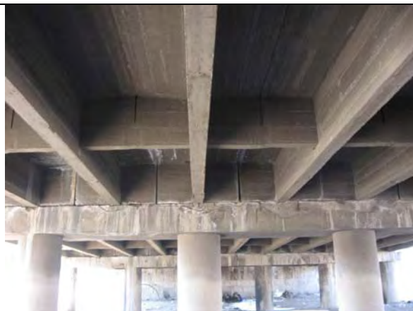
桁には沓はなく、梁に直接設置されているため、温度変化時の応力集中により各桁下の橋脚梁が損傷している。橋脚張りには遊離石灰が見られるが、床版から流出したものと推察される。
