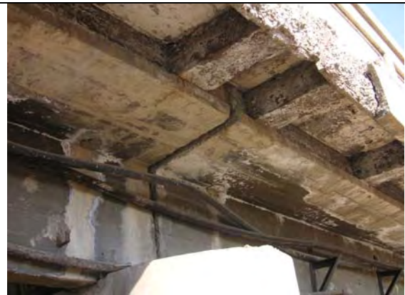
東側主桁端部の一部損傷（施工不良および凍害による）。床版の遊離石灰が桁まで流れ落ちている。
