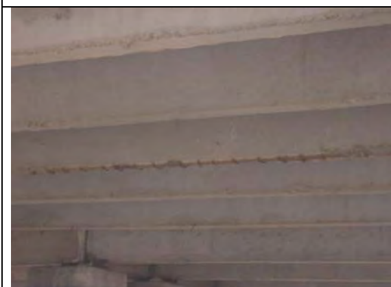
南側主桁下端部のコンクリート剥離と鉄筋の錆
