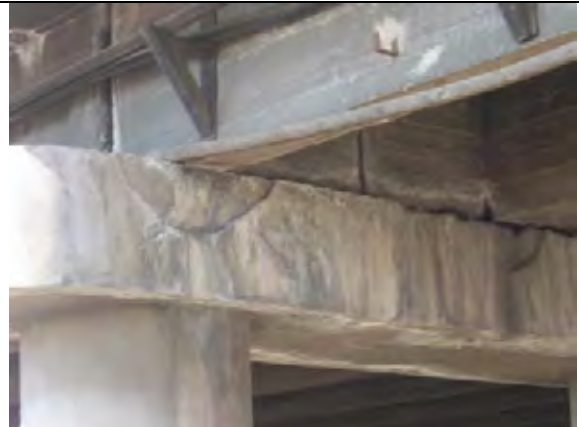
主桁下部と橋脚梁の損傷と 梁に流れ落ちた遊離石灰
