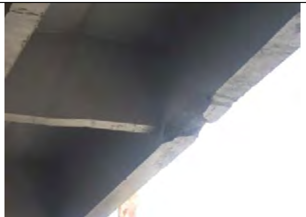
桁の一部に損傷が見られる。架設時の損傷と推定される。
