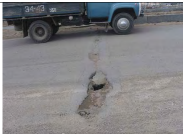
南側伸縮継ぎ手部の陥没、舗装のオーバーレイ時に継ぎ手の鋼製チャンネルが喪失
