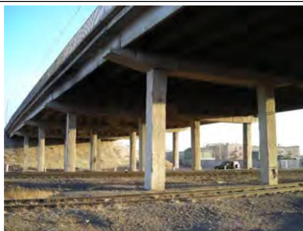
グルバルジン橋：1989年旧ソ連が建設。現在、床板、RC桁の損傷が激しい。橋脚はプレキャストブロックで建設されており、耐震性に劣る構造である。
