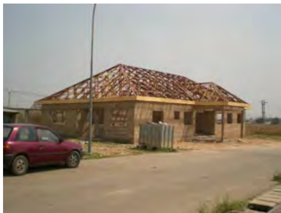
建設中のミンナ・ビジネス・サポートセンター (ナイジャー州ミンナ)
