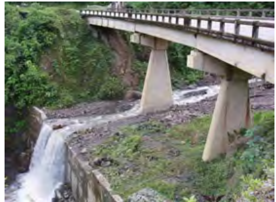
16. 土砂流によってピアが傾いた国道4号のアンタワカナ橋
