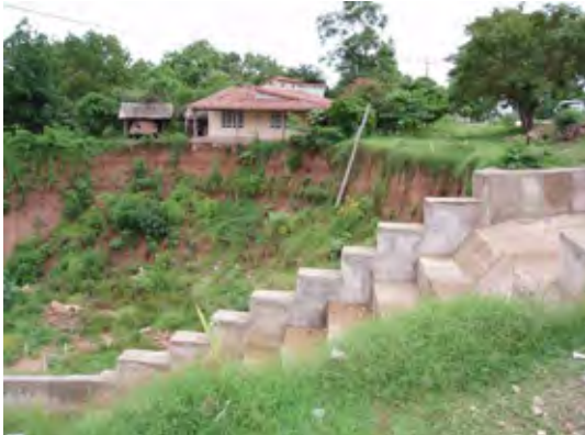
3. 国道 7 号線のプエルトリコ付近の河 岸の洗掘（段差工が本来の河道。家屋 の縁端まで洗掘された）
