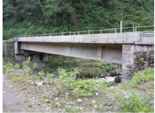
14. 土石流で流失し、2007年に完成した国道4号のポヒュマ橋
