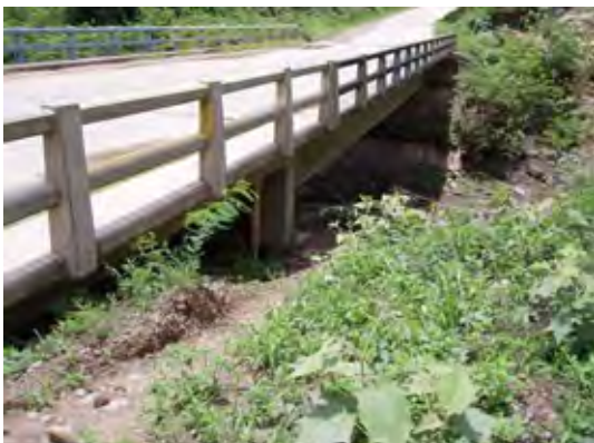
5. 地滑りによって橋台が移動した国道 7 号線のコロイコ橋
