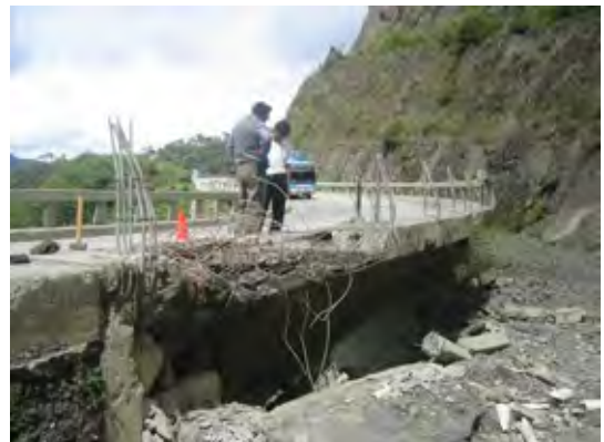
18. 斜面からの落石が衝突した国道3号上の橋梁
