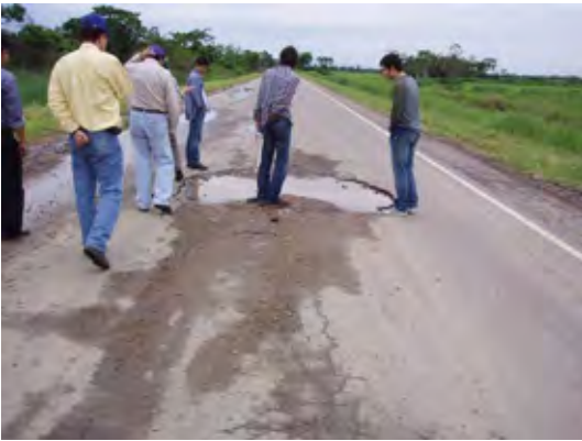
9. 路面損傷の多い国道15号のサンタフェ～サンファン間
