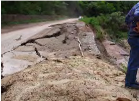
7. 国道7号線の盛土斜面崩壊による路面の変状箇所
