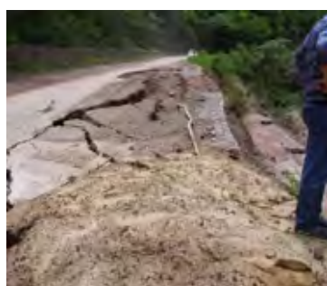
盛土斜面の崩壊 （国道7号線）
