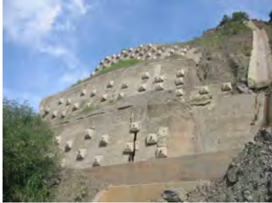
19. 崩壊したアンカー工 (国道3号コロイコ近郊)
