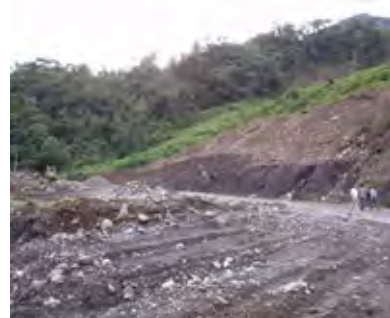
エルシジャールの地滑り崩壊 （国道4号線）
