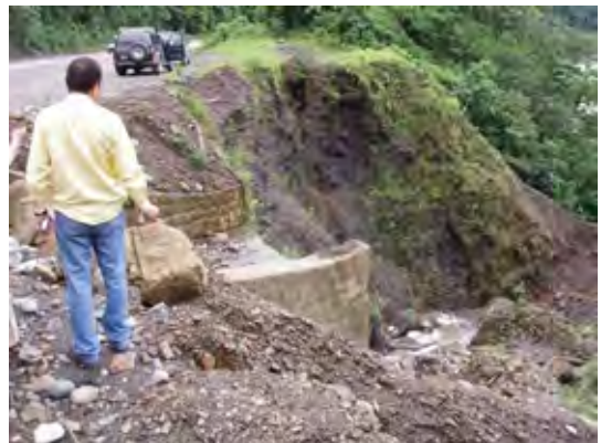
12. 洗掘されている国道4号のシェテクンパの管渠吐口
