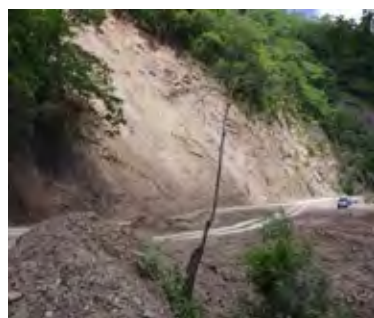
切土斜面の崩壊 （国道7号線）
