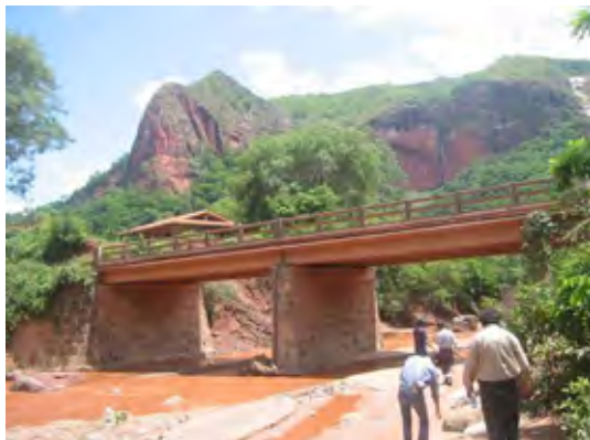
17. 河川水位が橋桁に達し、桁が河川色に染まっている国道7号
