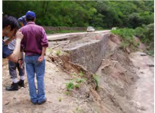
4. 蛇籠背面に亀裂が入り、変形した国道 7 号線の蛇籠工
