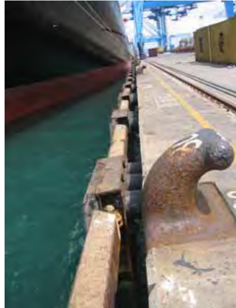
コンテナバース ・防舷材に損傷が見られる
