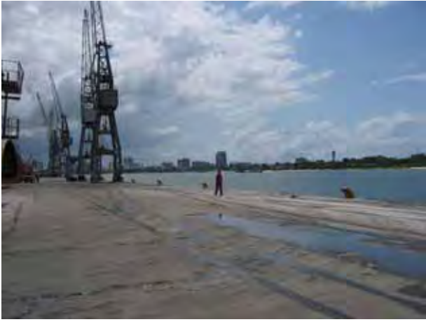
一般貨物バース エプロンに数多くの損傷、オイル跡が見られる
