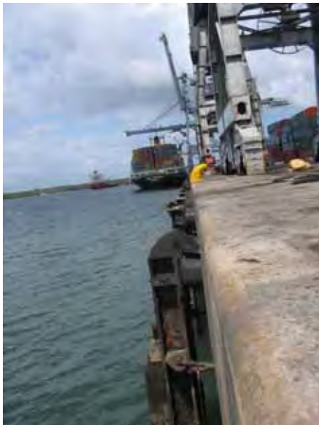
一般貨物バース(バース No.4) 防舷材は古く、損傷が激しい
