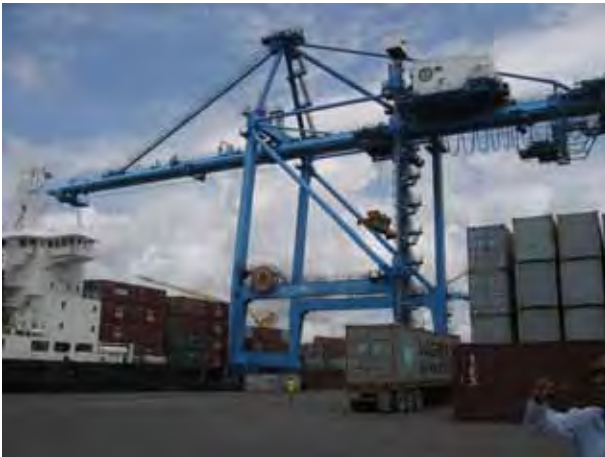
ガントリークレーン(SSG, 全4基)
