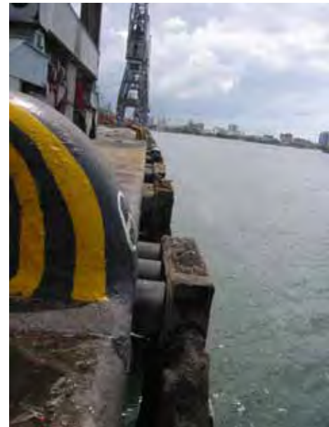
一般貨物バース(バース No.5) 防舷材は古く、損傷が激しい
