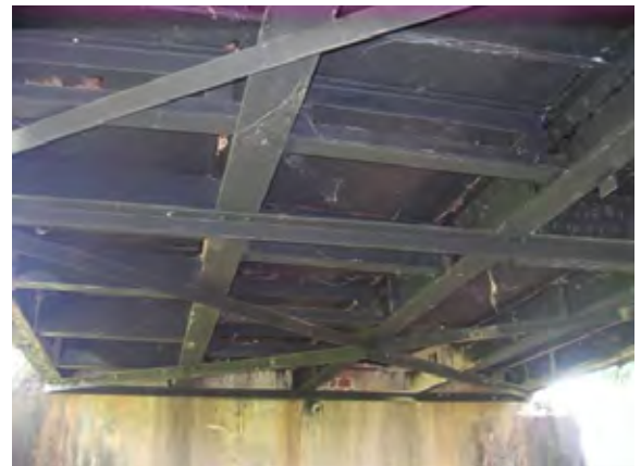
写真2-8 241/4橋 橋梁床組の損傷状況
