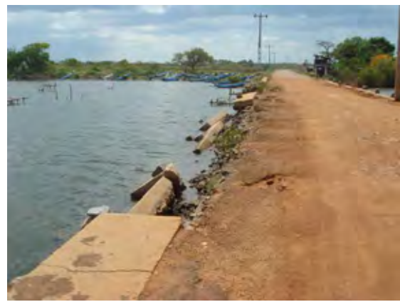
Bridge No. 5（パニチャンケニ・コースウェイ及び橋梁）の北側のコースウェイの様子
