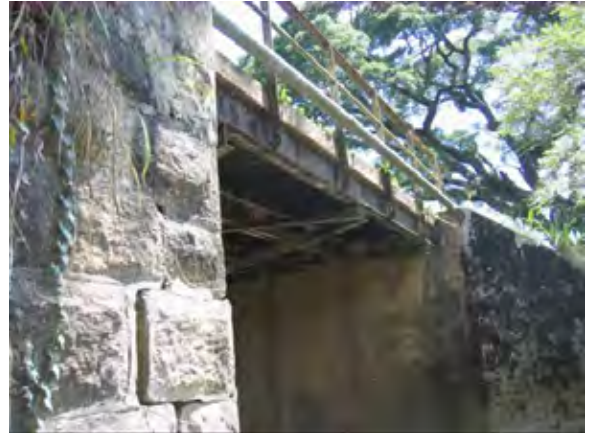
写真2-4 241/2橋 橋梁下面の損傷状況
