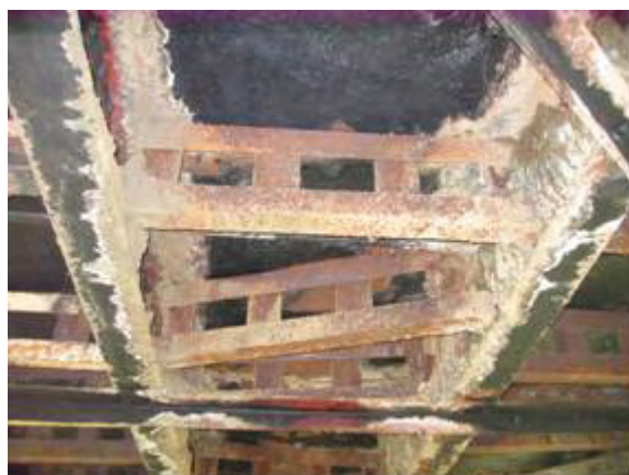
写真 2 - 2 240/4 橋 橋梁床組の損傷状況
