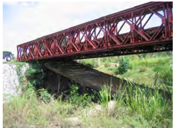
写真 2-10 247/2 橋 桁下に遺棄された旧橋
