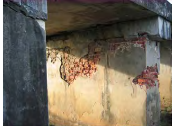
写真 2-12 283/7 橋 橋脚の損傷状況
