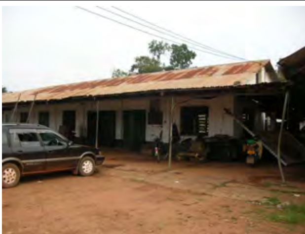
既存ワークショップ 修理作業場 躯体コンクリート、屋根ともに老朽化が激しい。室内は廃物が放置されたままであり、修理作業は写真建物の前面の屋外で行われている。
