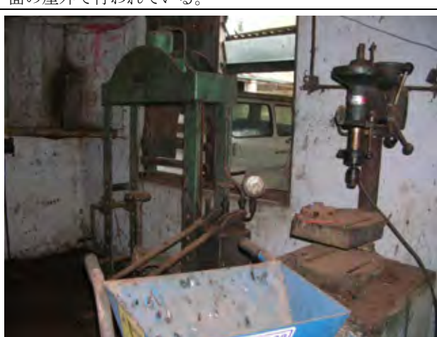
ワークショップ室内 ワークショップは5m×5m程度の作業室が3室程度設置されている。作業室内は穿孔機等の廃材が放置されており、室内での維持管理作業は困難な状況にある。
