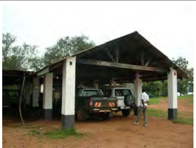
ワークショップの右側に隣接する車両修理場 コンクリート柱、木製梁、トタン屋根による簡易な構造からなる。柱はひび割れが見られる。車両修理は日常的に行われている。
