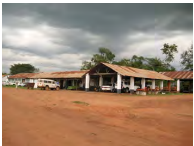
既存ワークショップ全景 写真右が車両修理場、左奥がワークショップである。屋根はトタンで錆による腐食が激しい。
