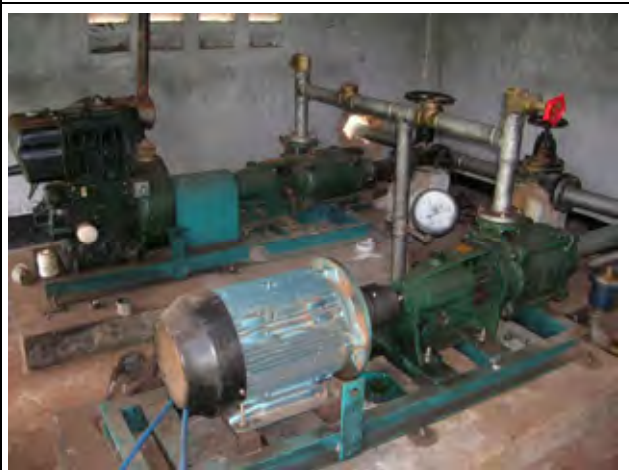
揚水ポンプ（左写真のポンプ小屋内部）
