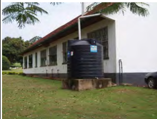
雨水集水プラスチックタンク 屋根に降った降雨を樋を通じて集水し、灌漑、また周囲の散水に使用している。複数のタンクが JICA により調達されている。
