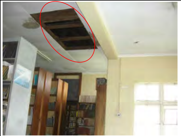
天井部の自然換気を目的とした通気口（図書資料室） 天井部の通気口は室内、廊下に設置されており、屋根裏部との空気の循環が効果的に行われている。
