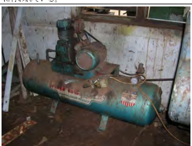
ワークショップ内のエア・コンプレッサー 使用可能であるが、耐用年数を大幅に超えており、更新が必要である。殆どの機材は交換部品が入手困難な状況にある。
