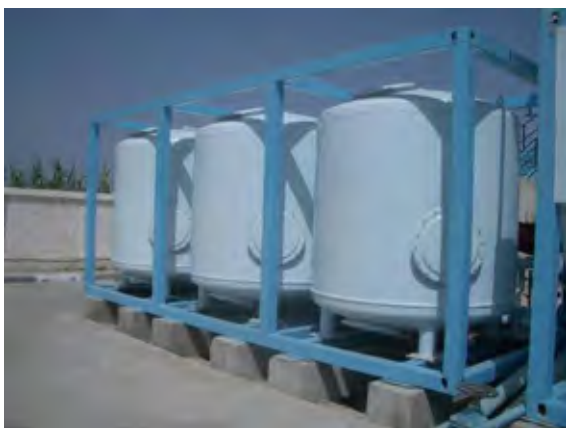
鋼製コンパクトユニット 処理量 30l/秒 (2,500m 3 /日) オランダ・オーストリア等の支援により設置。 フロック形成池・沈殿池も鋼製コンテナである。
