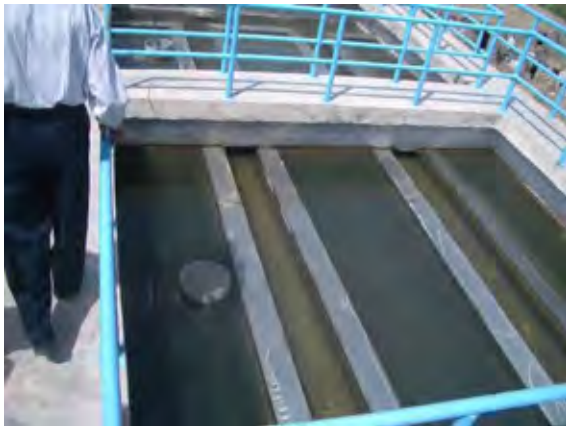
上向流式沈殿池 混和池・フロック形成池はない。 発生する汚泥は毎日除去し運河へ放流。
