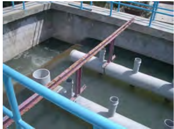
薬液注入槽 硫酸アルミニウムの注入量は近隣の浄水場より 水質分析官が来て調整している。
