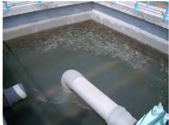
急速濾過池 ろ層の厚さは砂 1m・砂利(異なる粒径)1m ろ過速度不明、逆洗は 24 時間ごと。
