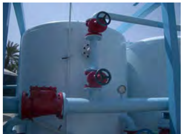
圧力式濾過装置 水槽・配管の腐食、水槽内部のシートの破損などメンテナンス上の問題が多い。
