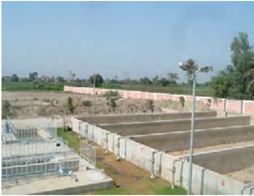
シャルキーヤ浄水場における汚泥の処理状況 シャルキーヤ浄水場の乾燥汚泥量は月に約350m 3 。
