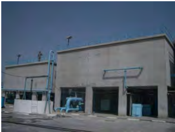
RC 製コンパクトユニット 処理量 90l/秒(7,800m 3 /日) 2003 年 NOPWSD 予算にて施工。
