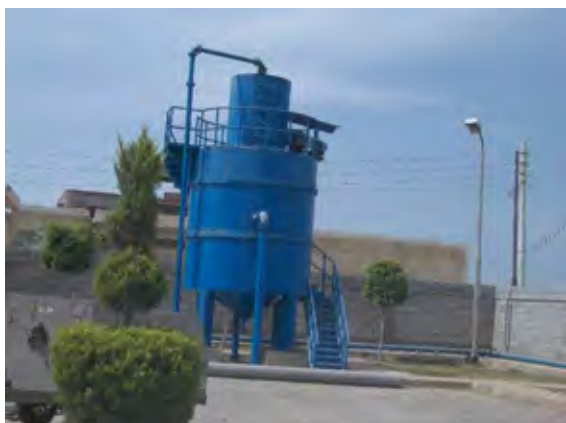
エアレーション・タンク
