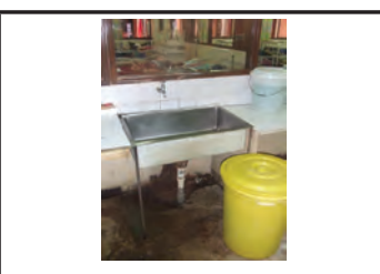
排水に不具合があるシンク
