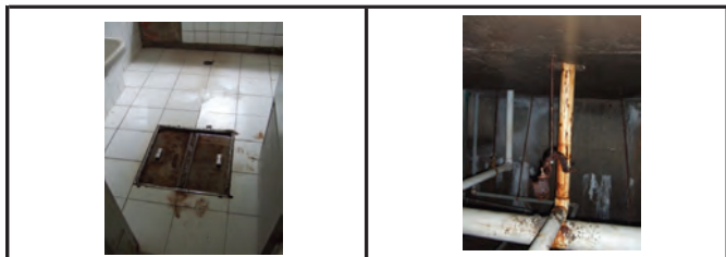
床排水口から排水が逆流する ピット配管内配管する
