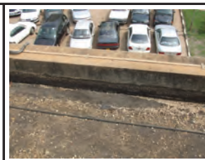
クラックが入った防水層
