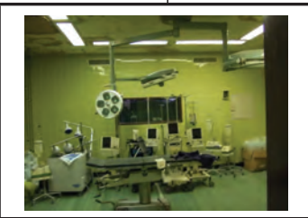
雨漏りで使用できない手術室
