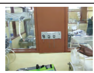
劣化が懸念される酸素取出口
