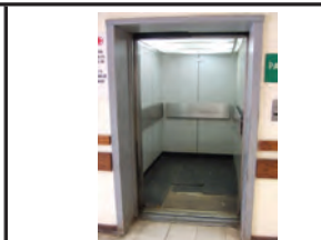
建設ときに設置されたE V
