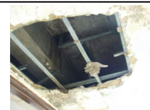
外来診察室前天井雨漏り
