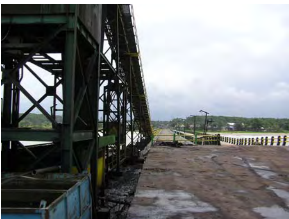
キンタップ地域 石炭積み出し用ベルトコンベア
