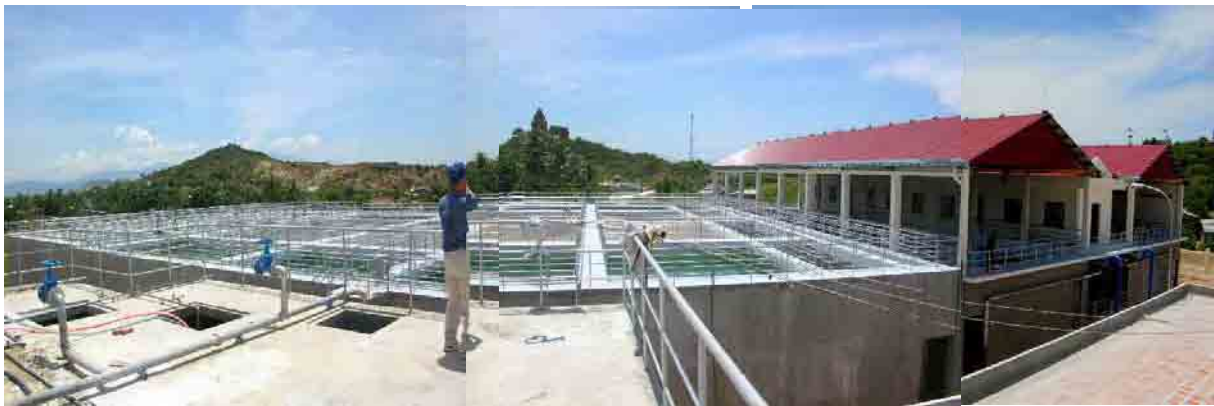
Trạm xử lý nước đô thị tại Ninh Thuận, Tháp Cham nhà máy, công suất: 20,000m 3 /ngày
