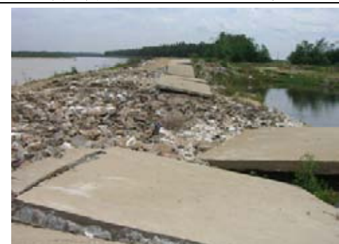
堤防（ADB が造成）の護岸崩壊：2007 年の洪水で被災、クアンナム省 Dai Loc 郡 Vu Gia 川
