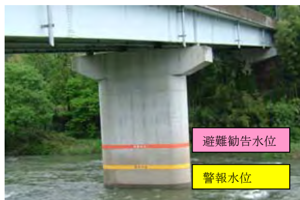
写真-2 洪水警報・避難システムのための水位標
