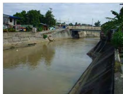
図 R 2.7 San Juan 川下流部の護岸崩壊
