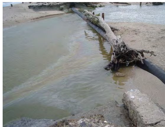
左のラグーンの海側にある使用していない PEMEXのパイプラインからの石油漏洩
