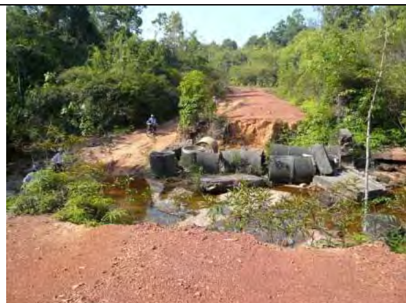
木材切り出し・運搬用に整備された道路であるが、雨季の洪水により道路が分断され、路床下の排水管がむき出しになっている。
