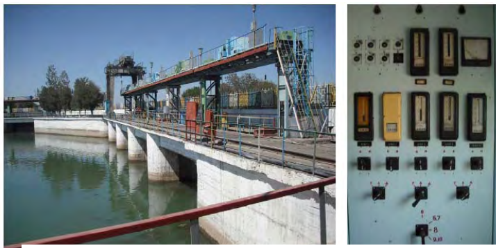
図 2-15 Dustlic Canal 取水設備（左）と取水設備操作のための電気制御盤（右）、（2008 年 9 月撮影）
