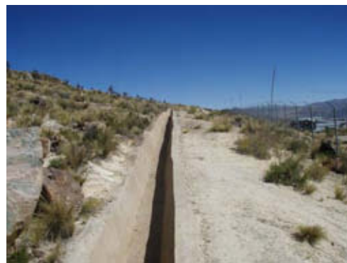
② 浄水場の西側上方斜面にある既設排水路には、ヘアークラックが分布する.
