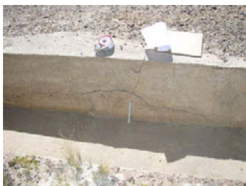
③ 既設排水路のヘアークラックの状況.
