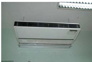
شكل 7-50 : مكيف الهواء داخل الغرف
