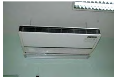
図 7-50 天井室内ユニット
