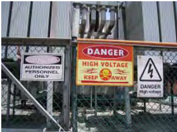
安全警告ポスター (重大危険箇所：高圧充電部への立入厳禁)
