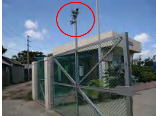
入構者管理（監視カメラの設置）
