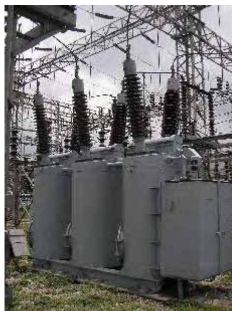
Figure I-5-5-6 132kV 変電所 OCB (1982 年製)
