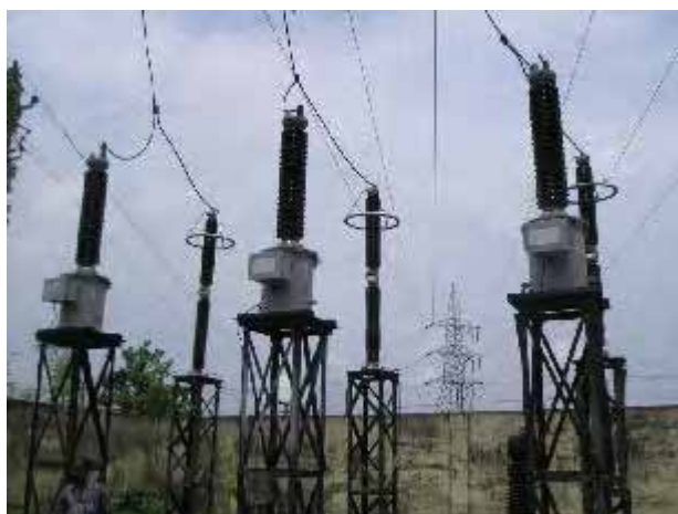
Figure I-5-5-4 取替後の 132kV 変電所 VCT と LA
