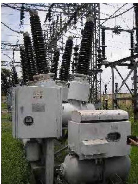
Figure I-5-5-5 132kV 変電所 GCB (1979 年製)
