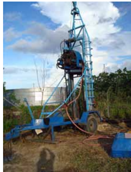
土質調査の様子(スカイライン配水池)。奥に見えるのが既設配水池。
