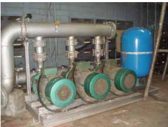
コングライ湧水の既設送水ポンプ設備(55kw x 3台)。本プロジェクトでは、高濁度対応型調整池の建設により移設され、緊急用送水ポンプ設備となる。
