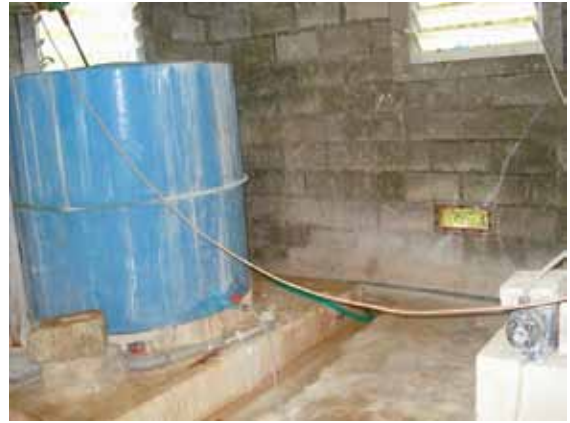
既設の塩素注入設備の様子(マタニコ配水池)。
