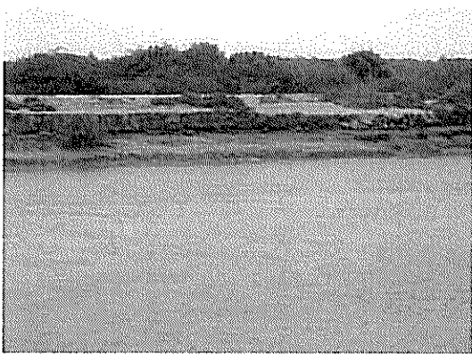
写真-3 シンド県 LBOD 水路河岸崩壊状況
