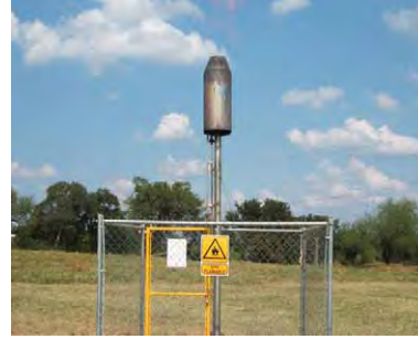
写真6 メタンガス燃焼設備
