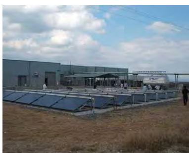
写真3 温水供給システム
