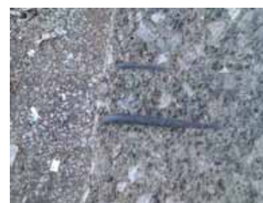
4. 磨耗による堰本体での配筋露出
