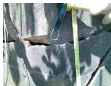
3. 堰本体コンクリート部の破損
