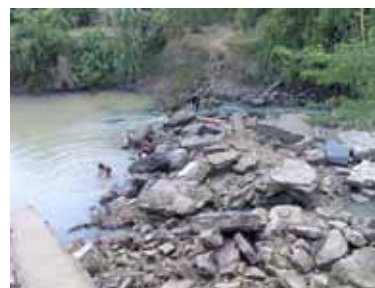
2. 損壊した分水施設
