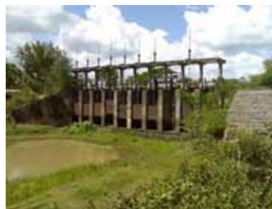
1. 既存取水堰（上流側）。ゲートは十分に機能していない。
