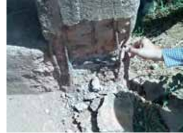
1. コンクリートの劣化と露出した鉄筋
