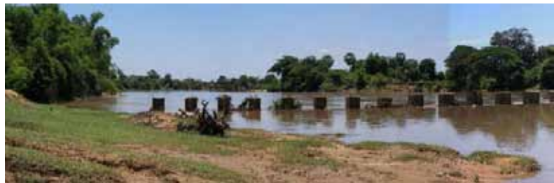
プルサット川の頭首工橋脚残骸 (ワット・ロウン改修サブ・プロジェクト)
