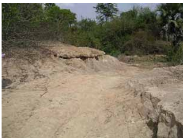
損壊している幹線用水路 (ワット・ロウン改修サブ・プロジェクト) (2008年2月2日)
