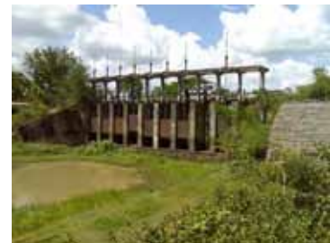
ゲートの稼働しない頭首工の現況 (リアム・コン改修サブ・プロジェクト)
