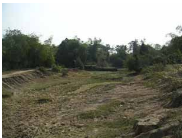
損壊し機能していない既存頭首工 (ワット・チェレ改修サブ・プロジェクト) (2008年2月5日)
