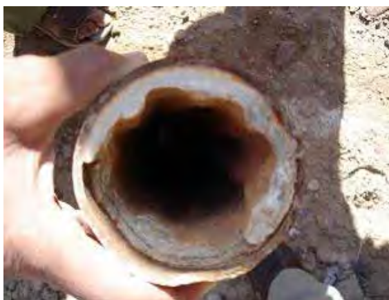
Dépôt calcaire dans les conduites de distribution
