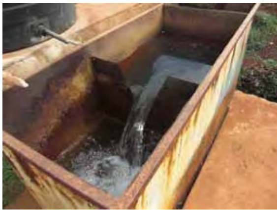
カンガル浄水場。 コンポジットトリートメントユニット。流入堰
