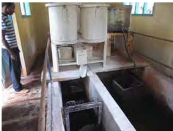
カンガル浄水場。さらし粉注入設備。
