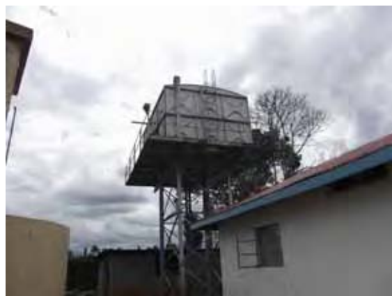
カンガル浄水場。逆洗水槽。 原水をヘッドで貯留し逆洗水として使用。
