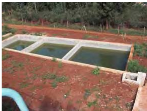
EWASCO が建設中のムカング浄水場。 排泥槽。汚泥の移送先は決定していない。
