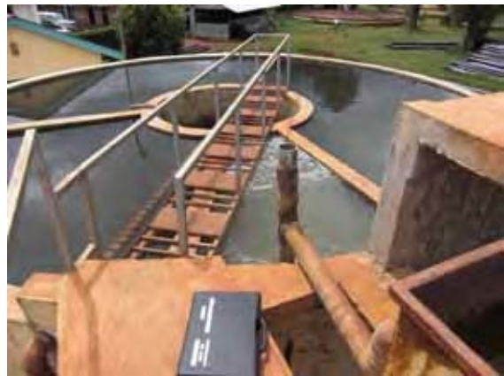
カンガル浄水場。 コンポジットトリートメントユニット。
