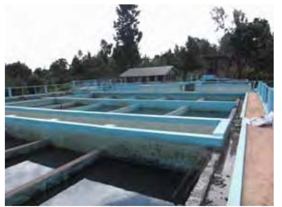
EWASCO が建設中のムカング浄水場。 沈澱池。越流レベルの施工ミスため補修中。
