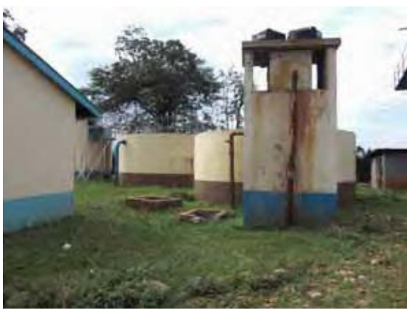
カンガル浄水場。 コンポジットトリートメントユニット。
