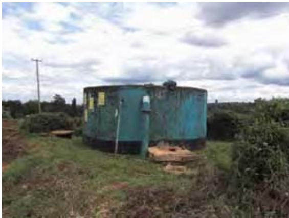
減圧水槽。導水管、送水管の途中に建設されている。
