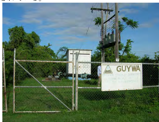
【事業化調査対象区域】既設スプリングガーデン井戸ポンプ場。現在既設配水管に接続して住民に給水している。この井戸が2期工事のクィーンズタウン浄水場の水源となる。
