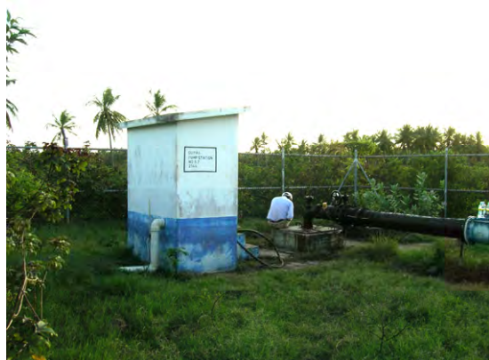
既設 No. 57 集落井戸ポンプ場。現在既設配水管に接続して住民に給水している。この井戸が1期工事のNo. 56 集落浄水場の水源となる。
