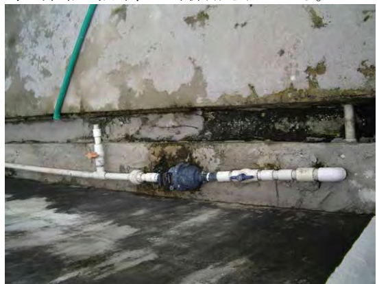
各戸給水箇所の水道メーター設置状況。給水管は露出し、カバーが無いいためメーターの損傷が問題である。
