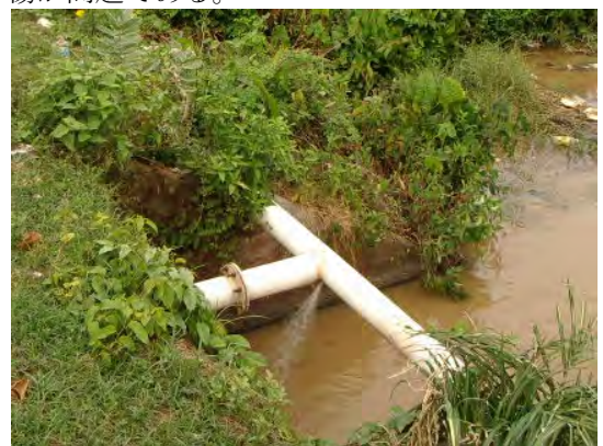
配水管からの漏水。露出しているために破損したと思われる。
