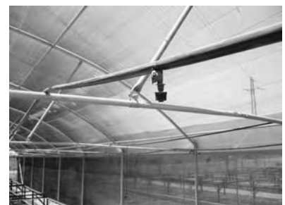
スプリンクラーによる散水装置
