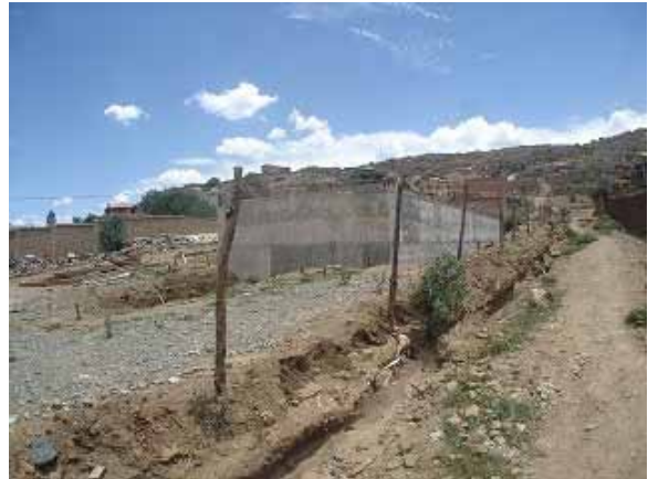
La Estación de Bombeo Siglo XX donde se propone instalar la bomba de transmisión.
