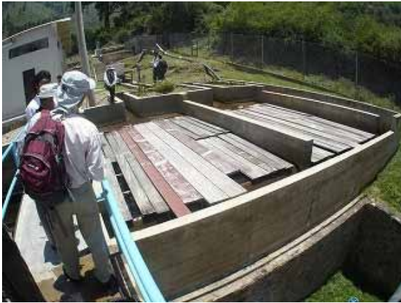
El tanque de sedimentación existente en la Planta de Tratamiento Aranquez. Su funcionamiento no satisface la demanda por su reducida capacidad.
