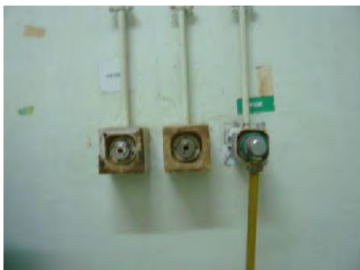
医療ガス配管があるが配管が傷んでおり、使われてない。
