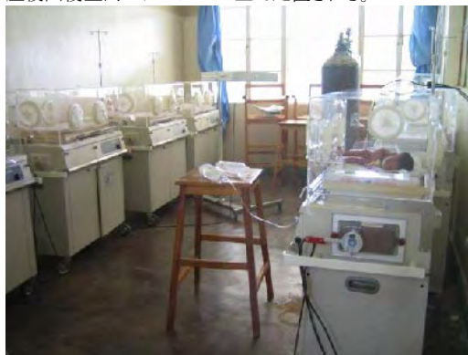
PRC 病院で生まれた未熟児は保育器に移される。中央配管設備が故障しているため、酸素の供給にはボンベを使っている。
