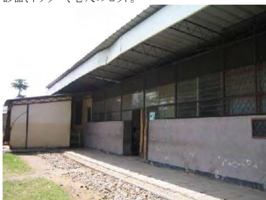
ンガガラ保健センター。建物は建築から50年以上経過しており、老朽化が目立つ。
