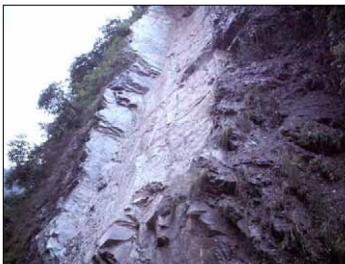
図 5.3.1 岩石崩壊が発生した斜面
