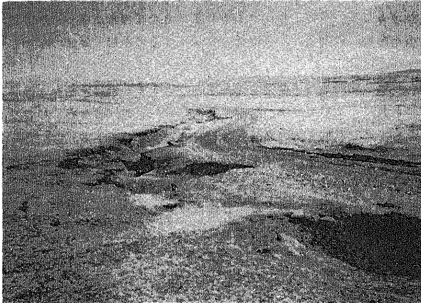
写真 5 - 3 排水処理が悪く道路が負傷を受けた例
